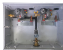
ARMARIO A-10, Caudal 10 m³/h, con seguridad máx. y mín. 2 Contador G-4
