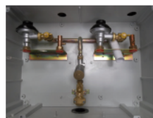
ARMARIO A-10, Caudal 10 m³/h, con seguridad mín. 2 Contador G-4
